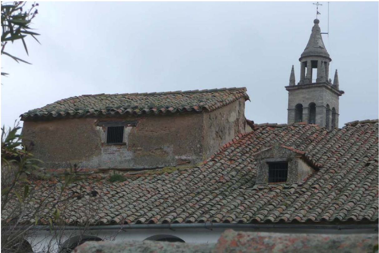
Foto 8. Detalle de cubiertas a reparar. Extremo norte.
