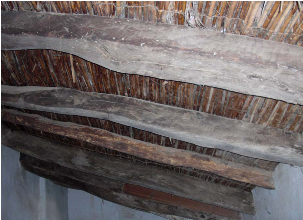
Foto 20. Faldón a la molinera con entrevigados de caña.
