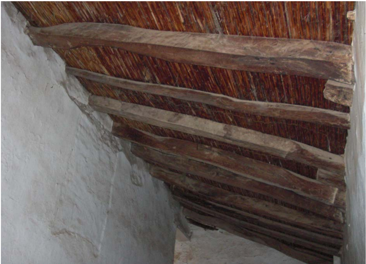
Foto 21. Faldón a la molinera con entrevigados de caña.
