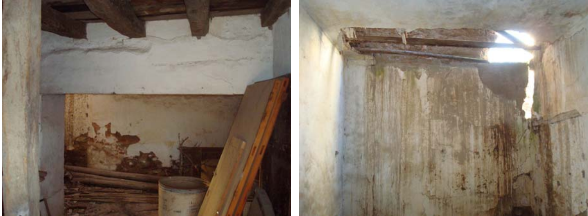
Fotos 15 y 16. Cuerpo de locutorio antiguo. El despegue de muros de la foto a la derecha corresponde por el exterior al de la foto nº 14.
