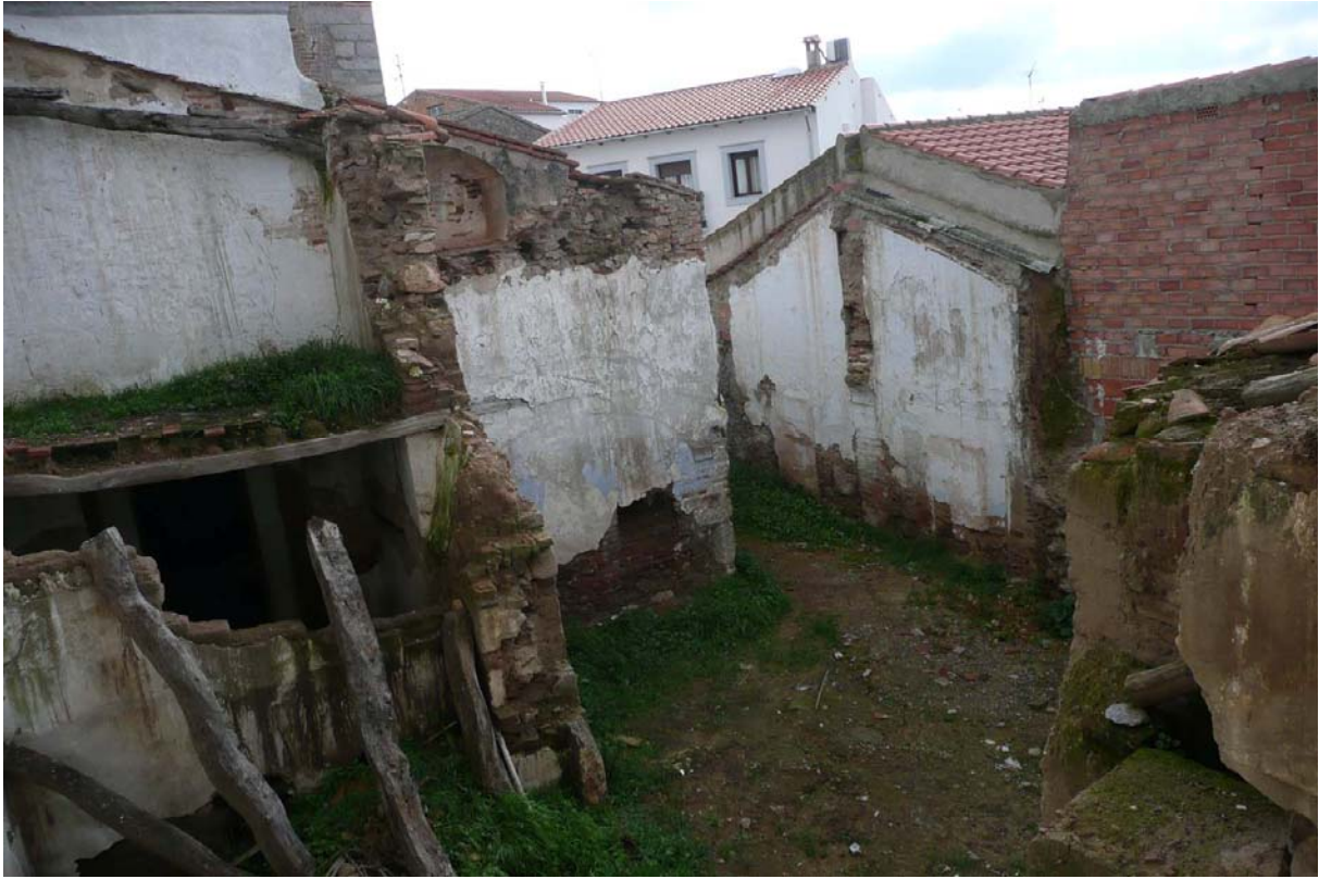
Foto 12. Casa arruinada de la c/ Monjas, nº 2. Antiguo patio de entrada al Convento.
