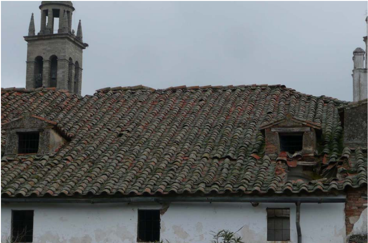
Foto 9. Detalle de cubiertas a reparar. Extremo central.
