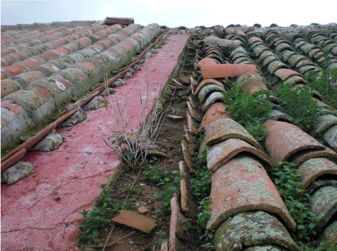
Foto 6. Encuentro entre tejado reparado y sin reparar.
